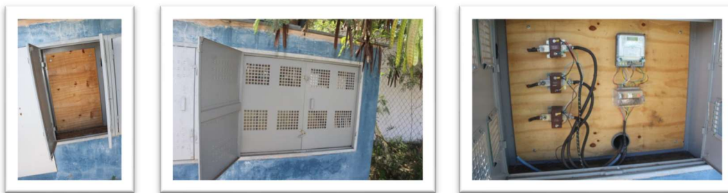
Fotos: 108 a 111 - Medidores de Energia BT- Iluminação do Estádio Próximo ao Setor 1
