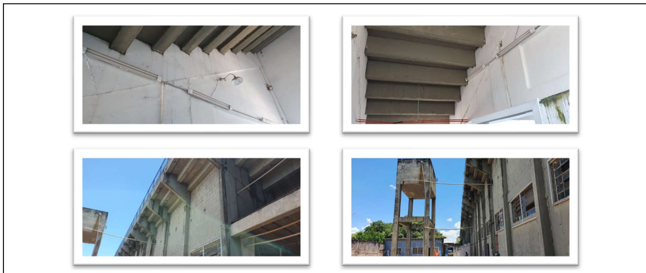
Fotos 21, 22, 23 e 24 – Manchas de infiltração nos sanitários abaixo do Setor 1 e no beiral da Arquibancada também no Setor 1
