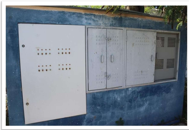
Foto: 217 – QDG - Iluminação do Estádio
