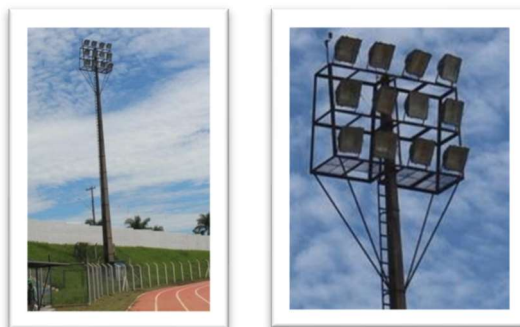
Fotos: 203 e 204 – Quadro de Iluminação Torre 3
