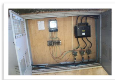
Fotos: 104 a 107 - Medidores de Energia BT Setor 1
