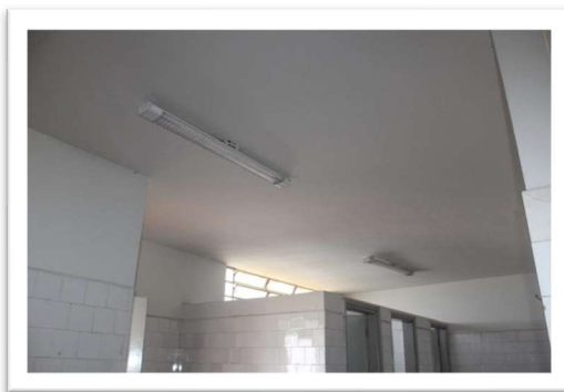
Foto 210 – Iluminação Vestiário dos Árbitros
