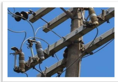
Foto: 93 - Chaves Fusíveis em condições satisfatórias
