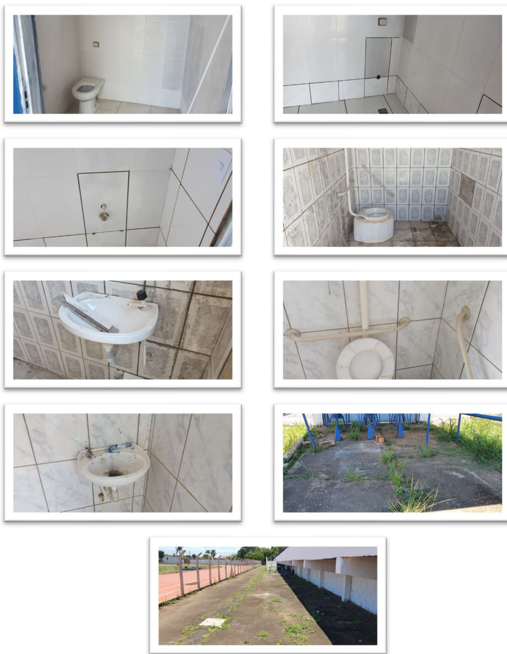
Fotos 260 a 268 – Sanitário PNE masculino do Setor 3 sem barras metálicas; Sanitário PNE feminino do Setor 3 sem barras metálicas (fotos 261 e 262); Sanitário PNE feminino do Setor 2 sem barras metálicas; Sanitário Masculino PNE do Setor 2 com barras metálicas próxima aos vasos sanitários; Sanitário Masculino PNE do Setor 2 sem barras metálicas próxima a pia; Acesso do Setor 1 próximo ao portão de entrada com presença de vegetação; Circulação do Setor 1 com presença de vegetação
