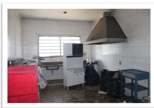
Foto 213 – Iluminação de Emergência – Cozinha
