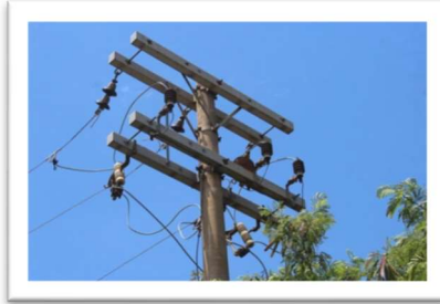
Foto: 91 - Cruzetas em condições satisfatórias
