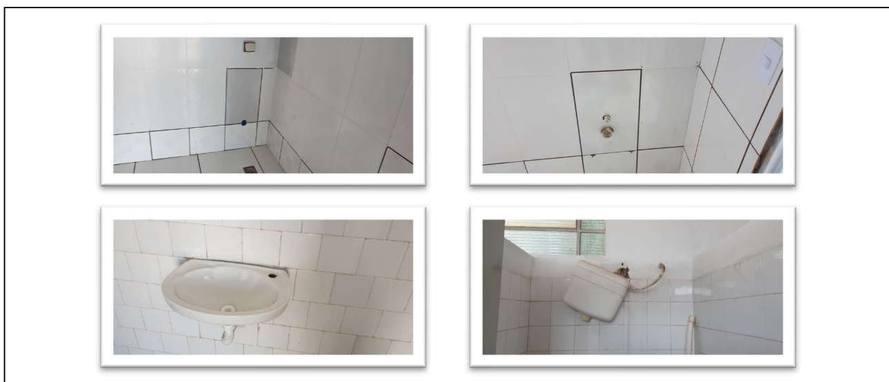
Fotos 83, 84, 85 e 86 – Sanitário Feminino do Setor 3 (fotos 83 e 84); Sanitário Feminino do Setor 2 (fotos 85 e 86)
