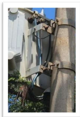
Foto: 97 - Saídas dos Cabos Aéreos em condições satisfatórias
