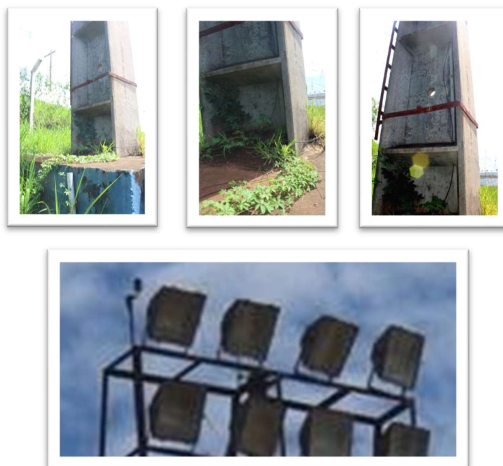
Fotos: 227 a 230 – Quadro de Iluminação Torre 3
