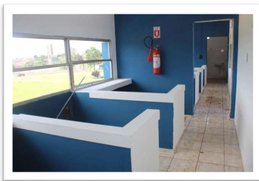
Foto 212 – Iluminação de Emergência – Cabine de Imprensa
