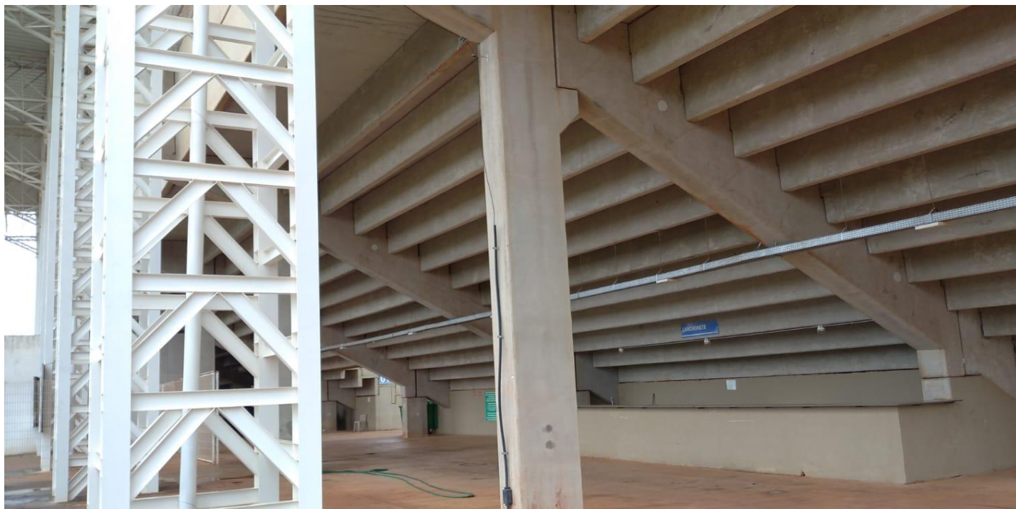
Foto 9 - Detalhe das vigas e pilares da estrutura pré-moldada de concreto aparente, além da estrutura da arquibancada vista pelo lado inferior. Eletrocalha com iluminação de emergência. Pilares metálicos da estrutura de cobertura do setor 1.
