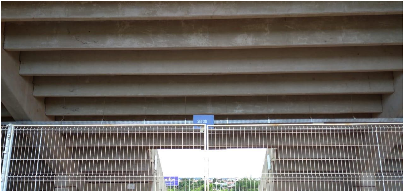
Foto 11 - Detalhe das vigas e arquibancada da estrutura pré-moldada de concreto aparente, e a entrada principal do setor 1 do estádio, localizada na arquibancada oeste.
