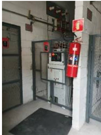
Figura 3: Cabine Principal: Barreira contra incêndio em bom estado.
