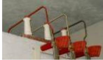
Figura 37: Bucha de passagem interna – Classe 15kv em bom estado de conservação.
