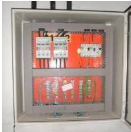
FIGURA 92B - QUADRO DE FORÇA - COBERTURA
