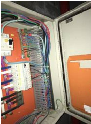
Figura 123: QF C. Máq. - 3Ø - 380/220V + N + T - 60 Hz - Setor C - Quadro sem condições de operação.
