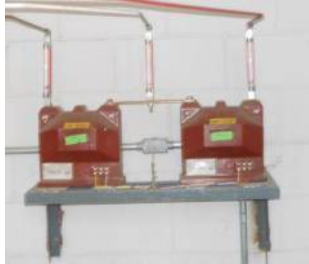
Figura 8: Cabine Principal: Transformador de potencial em bom estado de fixação.
