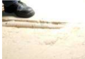
Figura 51: Cabine secundária: Piso irregular necessitando de acabamento.
