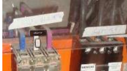
Figura 55: QDG – BT2 - NORMAL/EMERGÊNCIA: Identificação precária dos componentes e avisos.
