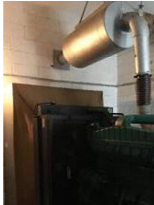
Figura 22: Cabine Principal - Grupo Moto-Gerador: Tomada de ar externo em bom estado de conservação.
