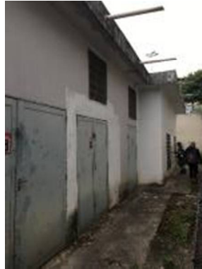
Figura 48: Cabine secundária: Apresenta local delimitando a área da cabine e presença de grelhas coletora de água pluvial que necessita de limpeza.
