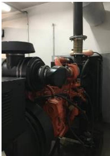
Figura 57: Grupo Motor-Gerador: Tomada de ar externo.
