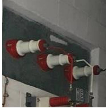
Figura 6: Cabine Principal: Bucha de passagem interna – Classe 15kv em bom estado de conservação.
