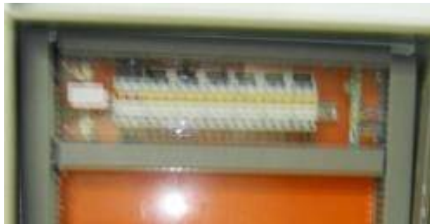
Figura 100: Alimentação lanchonetes - Setor B - Quadro em boas condições de uso e operação – Medição 1.
