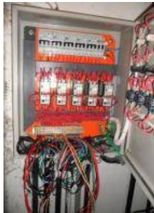
Figura 118: Quadro de bombas - QF. B. Rec. - A.P./ESG. - Torre 4 - Setor B - Quadro necessita de intervenção urgente, a fiação está exposta com grande risco ao operador.
