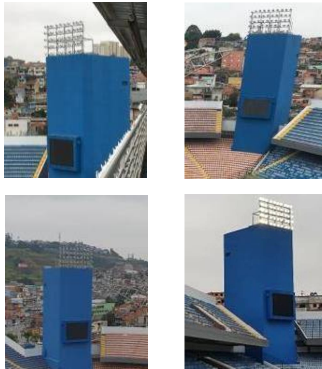
Figura 87 - Disposição das luminárias em bom estado, nas torres, sem problemas aparentes de fixação.
