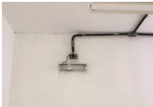
Figura 88A: Bloco autônomo do sistema de iluminação de emergência.
