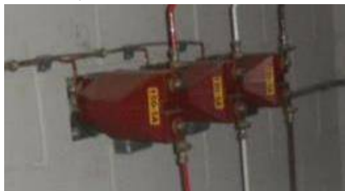
Figura 5: Cabine Principal: TC (Transformador de Corrente) com boa fixação na alvenaria.
