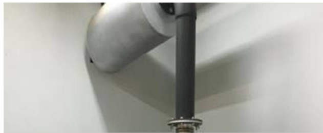
Figura 64: Cabine secundária - Grupo Moto-Gerador: Não apresenta tratamento acústico junto à casa de máquinas.
