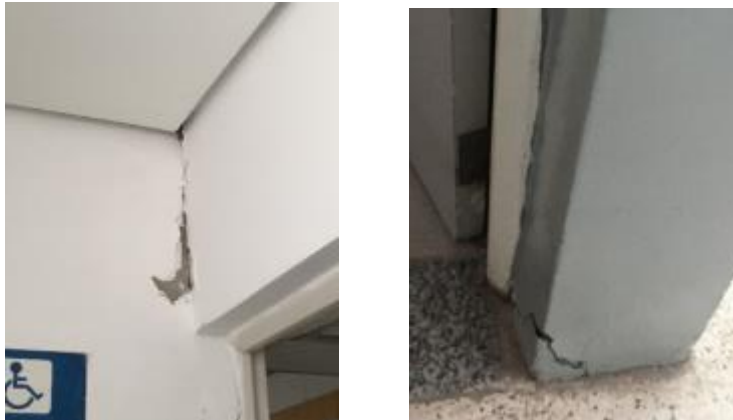
Figura 44 – Rachaduras nas alvenarias.
