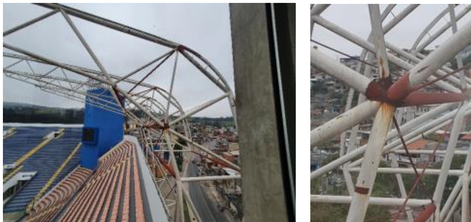
Figura 47 – Estrutura metálica da cobertura, inacabada, sofrendo processo de oxidação.
