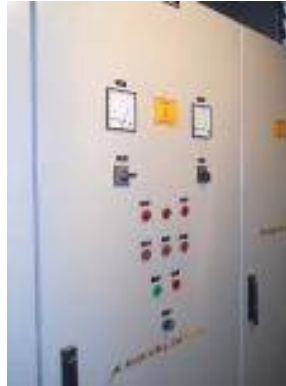
Figura 56: Cabine secundária - Grupo Moto-Gerador: Porta de acesso sem placa de aviso de equipamento energizado e sem símbolos indicativos.
