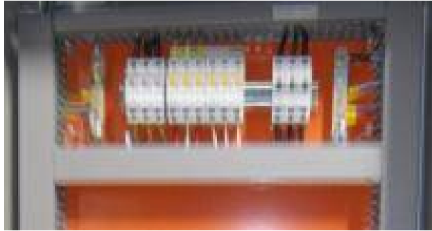
Figura 102: Alimentação lanchonetes - Setor B - Quadro em boas condições de uso e operação - Medição 3.
