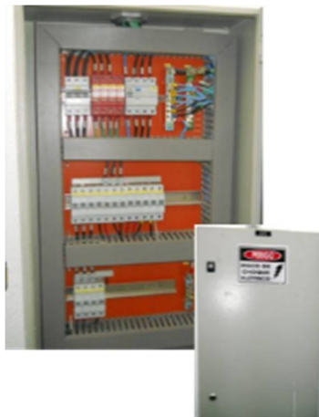
Figura 128: QF N 123 - Setor C - Quadro não apresenta placa de isolamento de partes vivas.
