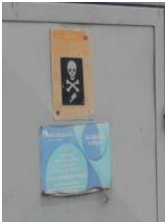
Figura 12: Entrada de Energia Cabine Principal: Aviso contra choques – Equipamento Energizado.
