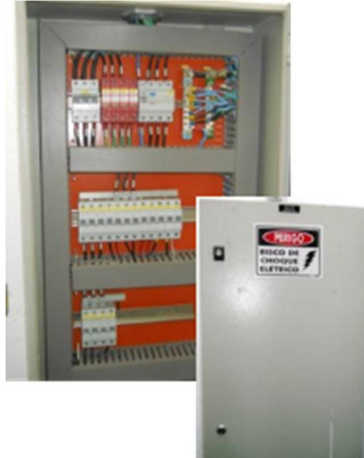
Figura 121: QDFL 113 - 1º Piso - Setor C - Quadro em bom estado de conservação e operação.
