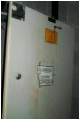
Figura 115: QDF – Torre 4 – QF. Elev. 4 – 60 Hz - Quadro em boas condições de uso e operação, porém, encontra-se sujo, necessitando de limpeza.
