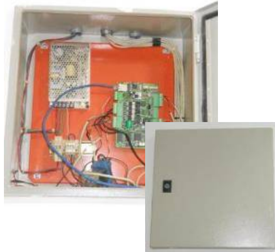
FIGURA 136 - QUADRO DE CONTROLE DE ACESSO - BILHETERIA
