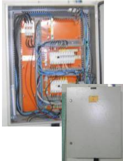
FIGURA 93 - QUADRO - TERREO 2 - SETOR A
