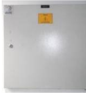
FIGURA 91 - QUADRO DE FORÇA ELEV - COBERTURA
