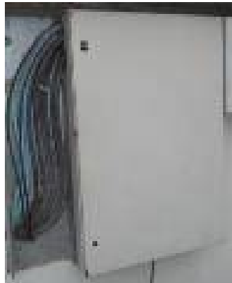
Figura 79: Quadro em boas condições de uso e operação, não apresenta placa de aviso de equipamento energizado.
