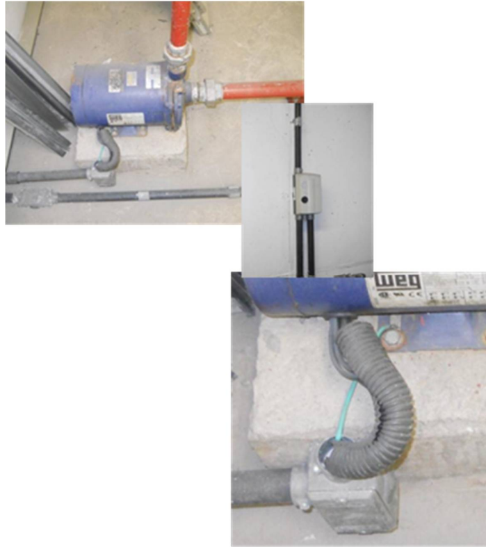
Figura 78: Setor A - Acionamento do motor e bomba de água pluvial.
