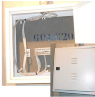
Figura 84: Quadro sem identificação funcional - QDG TEL – AUDITÓRIO E CAMAROTES (SEM IDENTIFICAÇÃO) – SETOR A.
