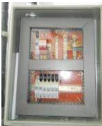
Figura 132: QT Tom. 127V - 1Ø + N + PE - 60 Hz - Setor C - Quadro em bom estado de conservação e instalação.
