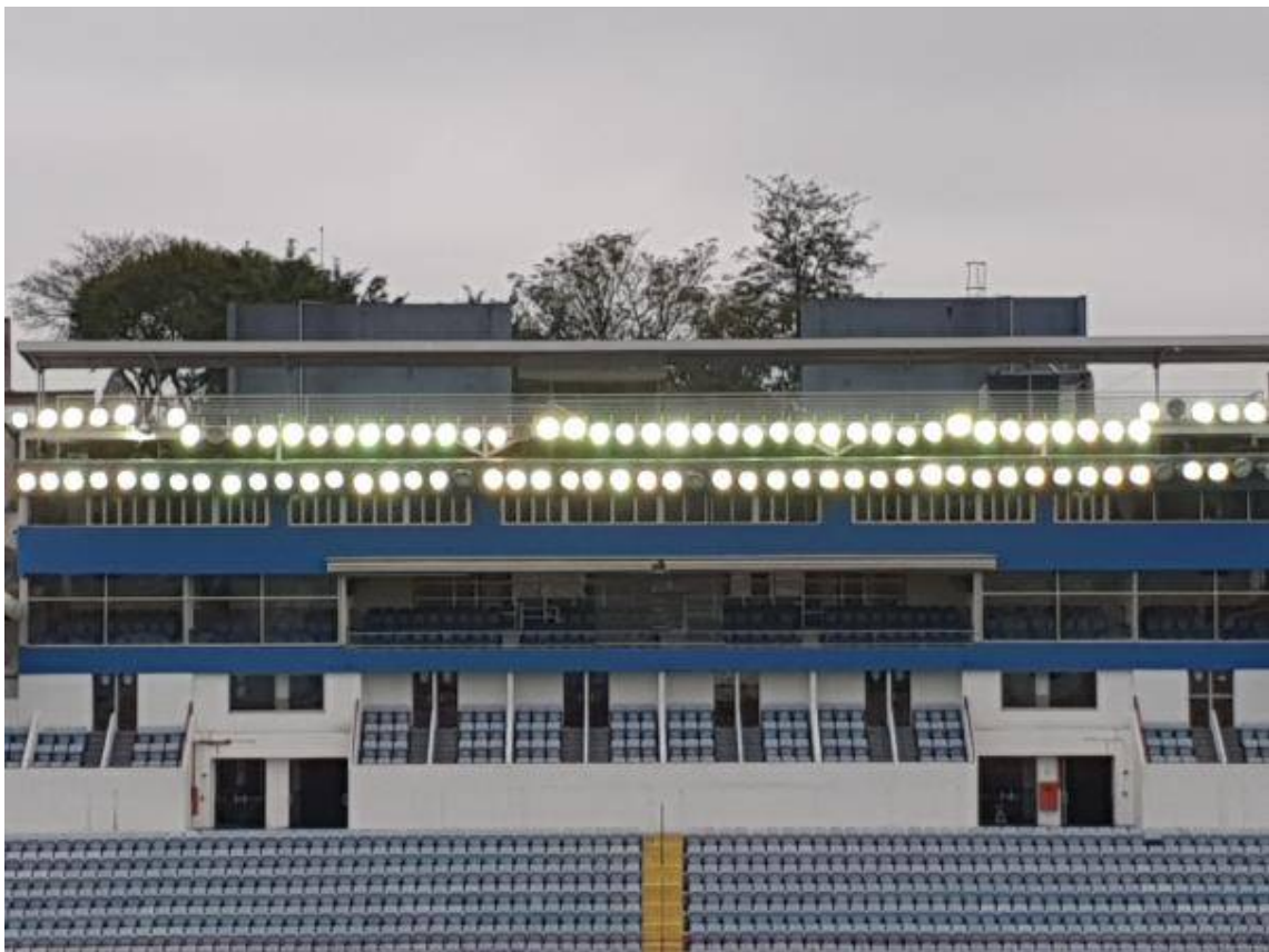
Figura 70: Arquibancada descoberta - Setor A - Localizado entre as torres 4 e 1 – Necessitando de verificação da área de cobertura do SPDA.
