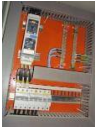
Figura 99: QF ELEVADOR - TORRE 4 - SETOR B
