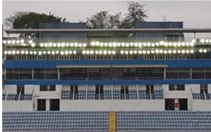
Figura 73: Setor A-disposição das luminárias em bom estado, sem problemas aparentes de fixação.
