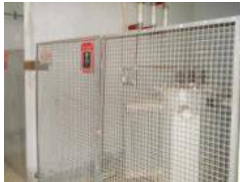
Figura 36: Cabine secundária: Grade de proteção bem instalada e com boa fixação.
