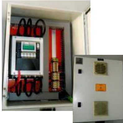
Figura 31: Casa de bombas: Quadro de soft starter.
