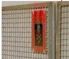
Figura 44: Cabine secundária: Placa de aviso - Cabine de transformação.
