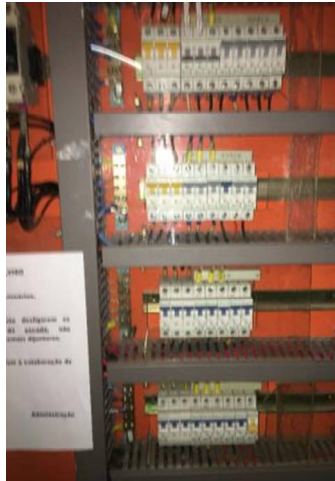
FIGURA 87 - QUADRO DE FORÇA - CABINE DE IMPRENSA – 5º ANDAR
