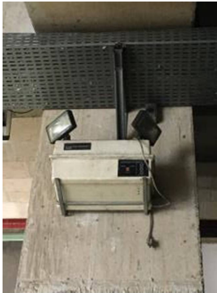
Figura 76B: Sistema de iluminação de emergência bem instalado, em conformidade com a norma.
