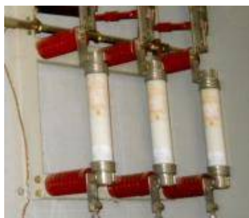
Figura 39: Cabine secundária: Base Fusível em bom estado de conservação.
