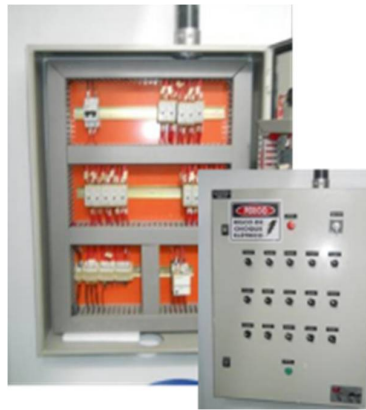
Figura 134: QT Operação Ilum. - Setor C - Quadro em bom estado de conservação e instalação.
