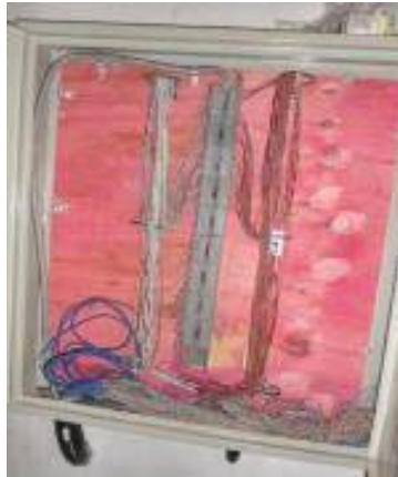
FIGURA 135 - QUADRO DG TELEFONIA - SETOR C
