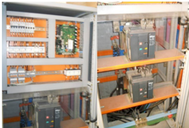
Figura 23: Grupo Moto-Gerador: Quadro de transferência automático em boas condições de uso e operação.
