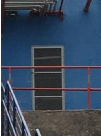
Figura 22: Casa de bombas: Local sem identificação e sem aviso de equipamento energizado.
