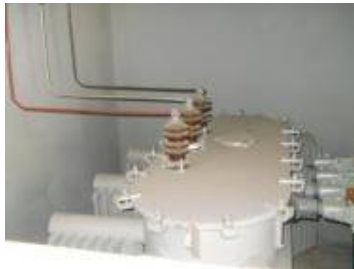
Figura 40: Cabine secundária: Transformador em bom estado de conservação.
