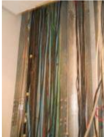
Figura 82: Quadros do setor VIP: Eletrocalhas sem tampa com fios soltos necessitando de manutenção.
