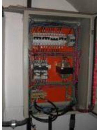
Figura 120: Quadro de bombas - 3Ø - 60 Hz - N+T - Torre 4 - Quadro necessita de melhorias nas ligações e caminhamento dos cabos.
