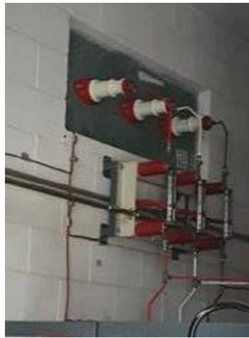
Figura 4: Cabine Principal: Dispositivos de seccionamento e comando em bom estado de conservação.
