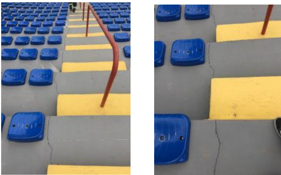
Figura 36 – Trinca na arquibancada.
