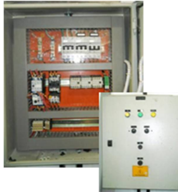
Figura 108: Quadro de bombas - Subsolo - Setor B - Quadro em boas condições de operação e funcionamento.
