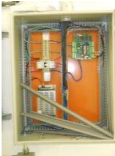
Figura 77: Quadro alarme - Setor A: Apresenta estrutura desmontada com eletrocalhas abertas necessitando de manutenção.
