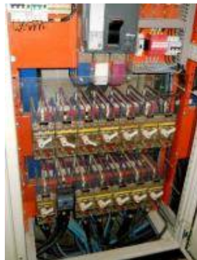
Figura 20: Cabine Principal: Grupo Moto-Gerador: Quadro de distribuição QDG-BT1 – NORMAL/EMERGÊNCIA.
