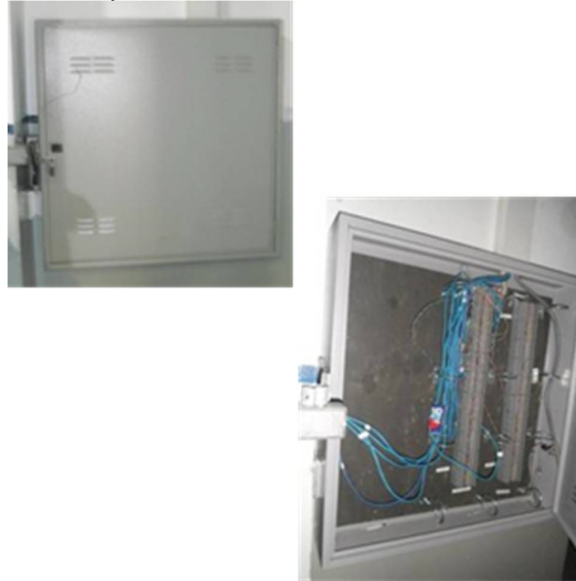
Figura 109: DG Telefonia - Sala de imprensa - Quadro sem identificação funcional / Estrutura interna em boas condições de utilização.
