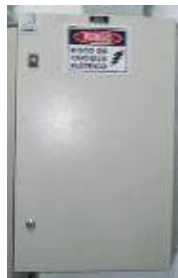
Figura 125: Quadro 102 - 3Ø + N + PE - 380/220V - 60 Hz - Setor C - Quadro apresenta eletrocalhas abertas sem fechamento.
