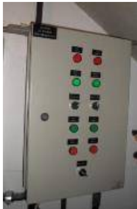
Figura 119: Quadro de bombas - 3Ø - 60 Hz - N+T - Torre 4 - Quadro com identificação e sem aviso de equipamento energizado.
