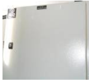
Figura 137: QLT - Bilheteria - 3Ø - Quadro com identificação funcional e sem placa de aviso de equipamento energizado.
