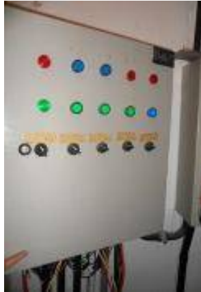
Figura 117: Quadro de bombas - QF. B. Rec. - A.P./ESG. - Torre 4 - Setor B.
