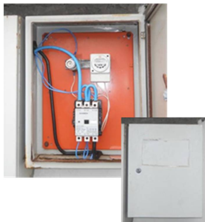
Figura 80: QFL - Entrada principal: Não apresenta identificação funcional e placa de aviso de equipamento energizado, internamente necessita de melhorias.
