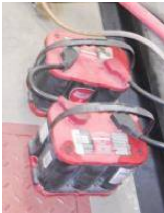
Figura 62: Cabine secundária - Grupo Moto-Gerador: Conjunto de baterias em bom estado de conservação.
