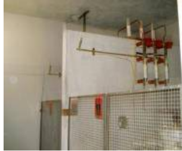
Figura 34: Cabine secundária: Instalação de grades e barreira contra fogo devidamente instalado e em bom estado de conservação.
