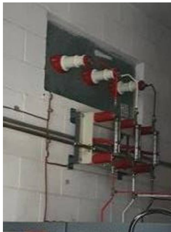
Figura 9: Bucha de passagem interna – Classe 15KV em bom estado de conservação.
