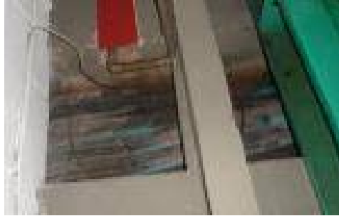
Figura 27B: Cabine Principal: Leitos ainda sem fechamento.
