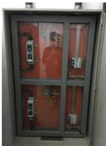
Figura 129: QF Elev. 13 e 14 - 3Ø + N + PE - 380/220V - 60 Hz - Setor C - Quadro em bom estado de conservação e funcionamento.
