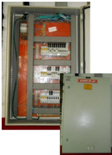
Figura 105: Quadro QT Subsolo 3 - Estacionamento - Setor B - Quadro necessitando de fechamento de eletrocalhas de PVC.
