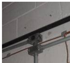
Figura 17: Cabine Principal: Não apresenta sistema de iluminação de emergência.
