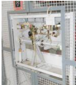
Figura 7: Cabine Principal: Disjuntor principal sem manutenção
