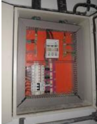
Figura 111: QDF - Torre 2 _ QF. ELEV 2 60 Hz - Setor B - Quadro em boas condições de uso e operação.
