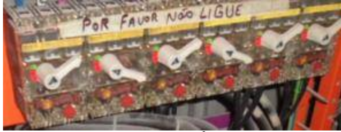
Figura 54: QDG – BT2 - NORMAL/EMERGÊNCIA: Identificação precária de componentes e avisos.
