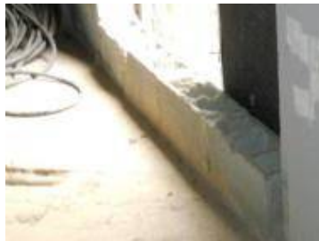
Figura 52: Cabine secundária: Mureta de contenção junto à porta da cabine.
