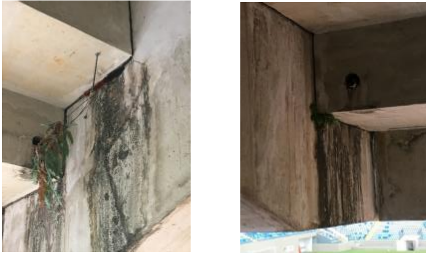
Figura 42 – Viga com sinal de infiltração.
