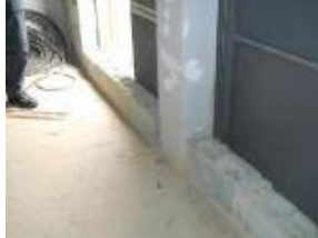
Figura 45: Cabine secundária: Não apresenta placa de isolamento para o operador, o local encontra-se limpo.
