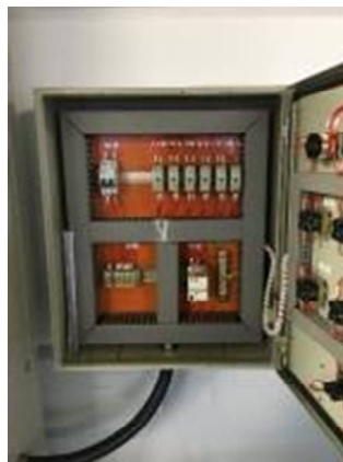
FIGURA 90 - QUADRO DE COMANDO ILUMINAÇÃO - CAMPO 01
