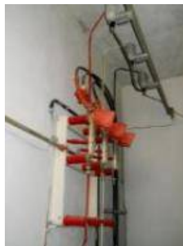
Figura 35: Cabine secundária: Dispositivos de seccionamento e comando em bom estado de conservação.
