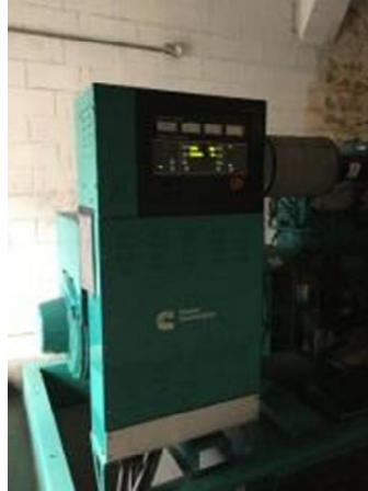
Figura25: Cabine Principal - Grupo Moto-Gerador: Base metálica com coxim de amortecimento.
