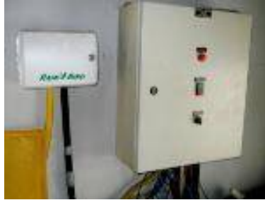
Figura 32: Quadro de bomba de irrigação sem placa de aviso de equipamento energizado.
