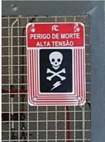
Figura 13: Aviso de equipamento energizado, "Perigo de Morte", bem instalado e em local visível.
