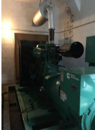
Figura 26: Cabine Principal: Grupo Moto-Gerador: Silenciador em bom estado de conservação.
