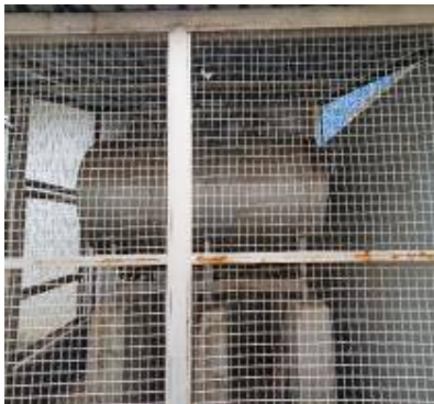
Figura 60: Cabine secundária - Grupo Moto-Gerador: Tanque de combustível em local arejado não apresenta muro de contenção de combustível.
