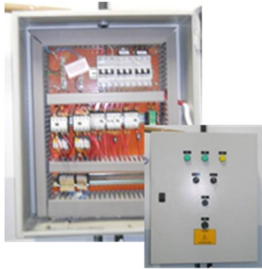
Figura 107: Quadro de bombas - 1/2 - Setor B - Quadro em boas condições de operação e funcionamento.
