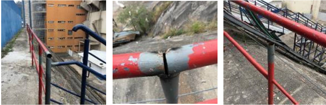
Figura 19: Cabine Principal: Área externa apresenta instalação de grade de proteção junto à área de declive.
