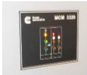
Figura 24: Cabine Principal - Grupo Moto-Gerador: Unidade de paralelismo de rede em bom estado de conservação e funcionamento.
