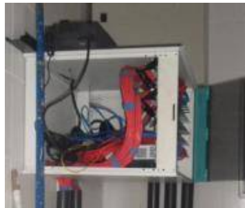
Figura 142: Quadro de rede - Bilheteria - Quadro necessita de fechamento das partes externas e identificação funcional.
