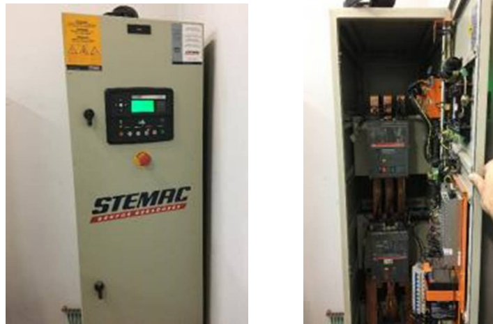
Figura 63: Cabine secundária - Grupo Moto-Gerador: Unidade de paralelismo de rede grupo.
