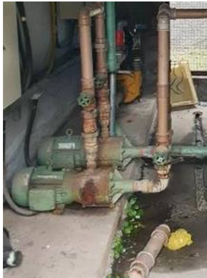
Figura 30: Casa de bombas: Bombas do sistema de abastecimento de água potável.
