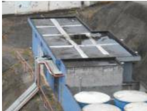
Figura 72: Cabine principal não apresenta sistema de SPDA.
