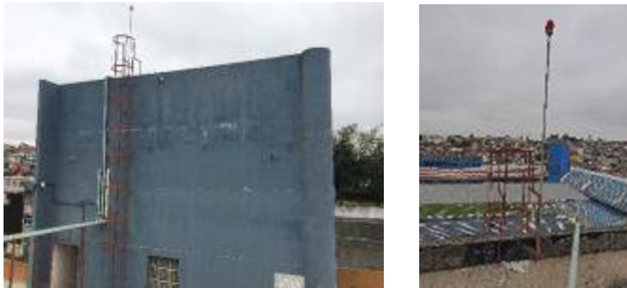
Figura 78A: Torre 1: Apresenta lâmpada de balizamento, contudo não foi observado o sistema de proteção contra descargas atmosférica conforme Norma NBR5419.
