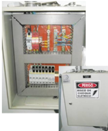
Figura 131: QT Tom. 127V - 1Ø + N + PE - 60 Hz - Setor C - Quadro em bom estado de conservação e instalação.
