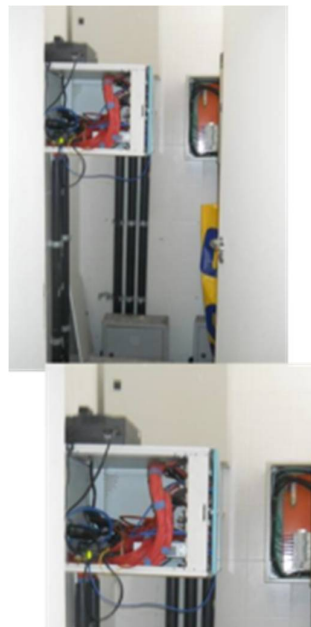
Figura 141: QLT - Bilheteria - 3Ø - Local com grande acúmulo de quadros, dificultando o acesso do operador..
