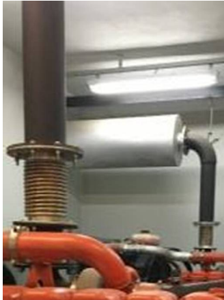
Figura 61: Cabine secundária - Grupo Moto-Gerador: Sistema de escapamento de gases.
