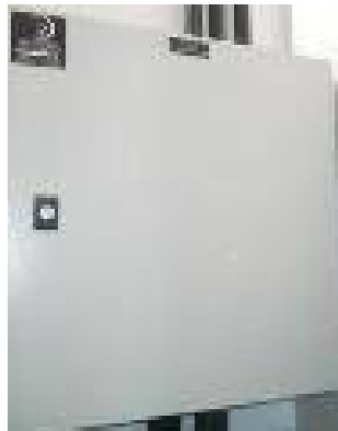
Figura 139: QF A.C. - Bilheteria - 3Ø - Quadro com identificação funcional e sem placa de aviso de equipamento energizado.
