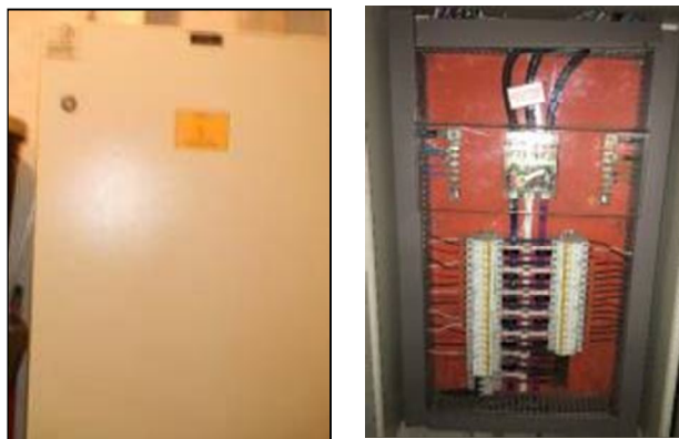
FIGURA 85 - QUADRO DE FORÇA AR CONDICIONADO
