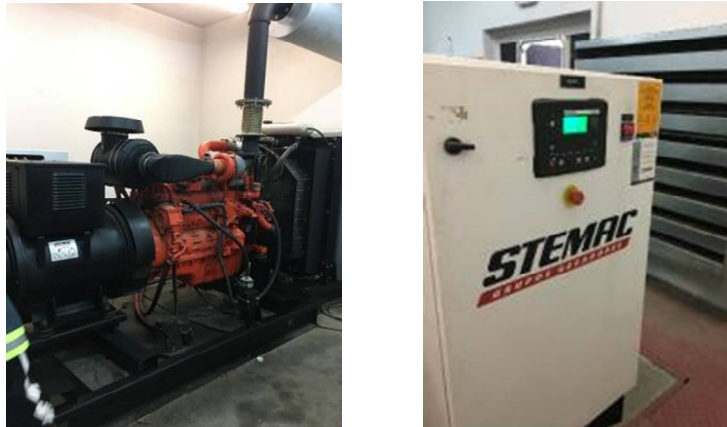
Figura 59: Cabine secundária - Grupo Moto-Gerador: Base metálica com coxim de amortecimento.
