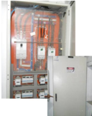
Figura 130 -QUADRO DE ILUMINAÇÃO DO CAMPO
