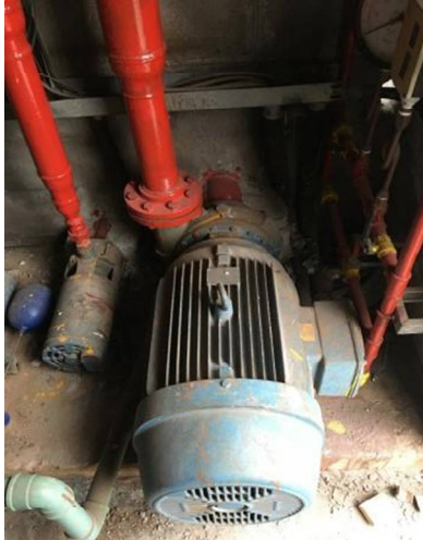
Figura 26: Casa de bombas: Bomba principal de incêndio.
