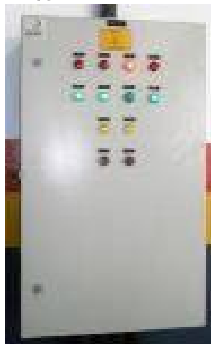
Figura 106: Quadro de bombas - QF-B REC - A.P./ESG - Estacionamento - Setor B.
