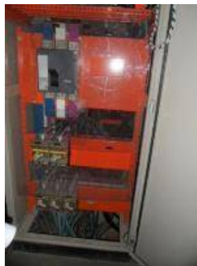
Figura 19B: Cabine Principal - Grupo Moto-Gerador: Quadro de distribuição QDG-BT2 – NORMAL.
