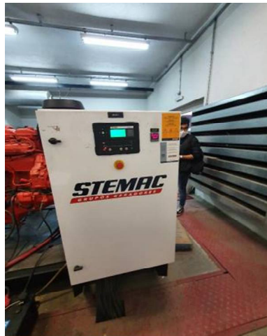
Figura 58: Cabine secundária - Grupo Moto-Gerador: Quadro de transferência automático.
