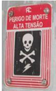
Figura 43: Cabine secundária: Placa indicando perigo bem localizada.
