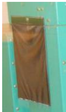
Figura 28A: Cabine Principal - Grupo Moto-Gerador: Porta-ficha.
