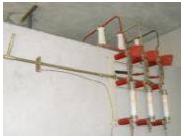
Figura 38: Cabine secundária: Dispositivos de seccionamento e comando.
