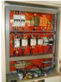
Figura 33: Quadro de bomba de irrigação: Estrutura interna necessitando de manutenção e melhorias junto ao encaminhamento dos cabos.
