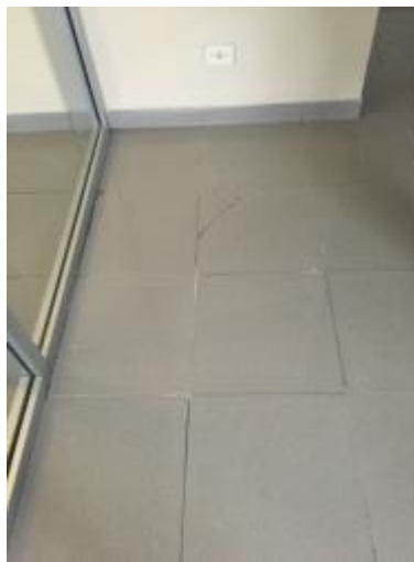
Figura 26 – Piso trincado e com infiltração
