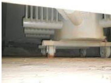
Figura 41: Cabine secundária: Trafo apresenta estrutura junto à base em boas condições de conservação.
