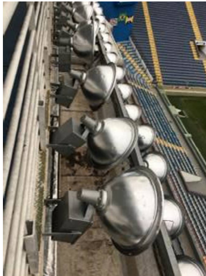
Figura 74: Setor A - Suporte de luminárias - Luminária e caixa suporte de reator.
