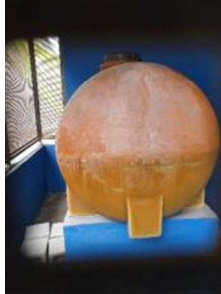
Figura 21: Grupo Moto-Gerador: Tanque de combustível bem instalado.
