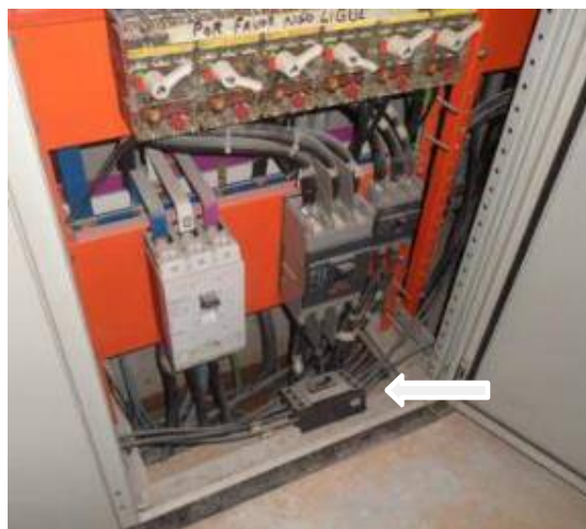
Figura 53: QDG – BT2 - NORMAL/EMERGÊNCIA: Identificação precária, instalação de disjuntor de maneira irregular com risco ao operador.
