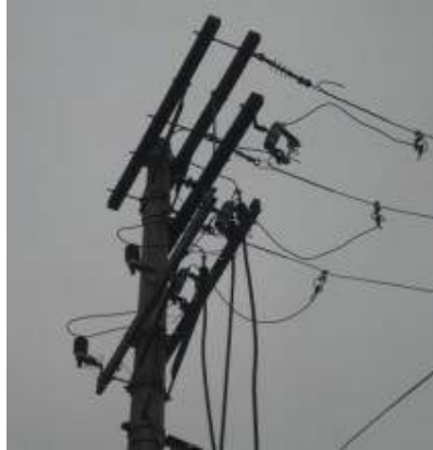
Figura 1: Entrada principal de energia em bom estado (Rua Presidente Epitácio Pessoa).
