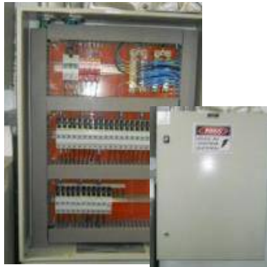
Figura 133: QD A.C. Cabines - Setor C - Quadro em bom estado de conservação e instalação.
