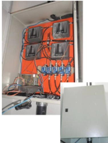
Figura 140: Quadro de controle CFTV - Bilheteria - Quadro sem identificação funcional e sem aviso de equipamento energizado, necessita de melhorias junto à adequação de cabos.
