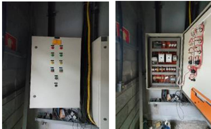
Figura 24: Casa de bombas: Quadro de bombas de incêndio.
