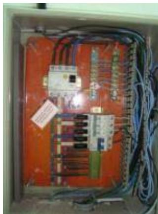
Figura 114: QDF - C. Máq. 4 - Cobertura - Torre 2 - Quadro necessitando de fechamento das eletrocalhas de PVC.
