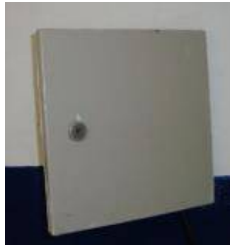
Figura 104: Quadro - Iluminação e tomadas - Setor B - Quadro sem identificação e sem placa de aviso de equipamento energizado.
