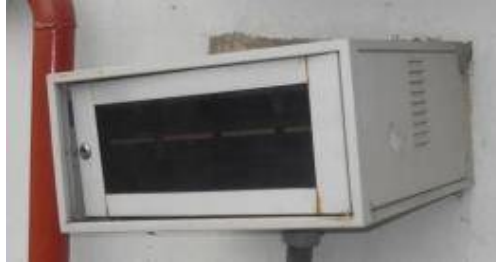
Figura 81: Entrada principal: Quadro de distribuição de telefonia na área externa.
