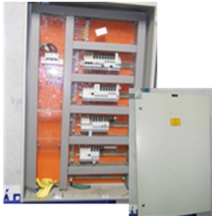
Figura 103: QT - TÉRREO 3 - SETOR B - Quadro em boas condições de operação.
