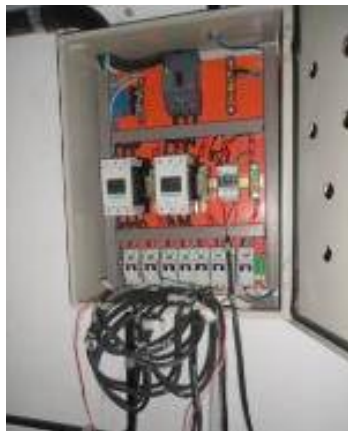
Figura 113: Quadro do placar - Torre 2 - Setor B - Quadro sem identificação e sem placa de aviso de equipamento energizado.
