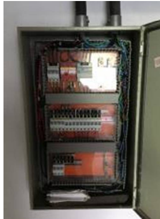
Figura 127: QDFL N 120 - 3Ø + N + PE - 380/220V - 60 Hz - Setor C - Quadro CC apresentando eletrocalhas abertas sem fechamento.
