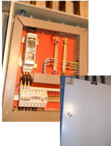
Figura 122: QF Elev. - Torre 3 - 60 Hz - Setor B - Quadro em bom estado de conservação.
