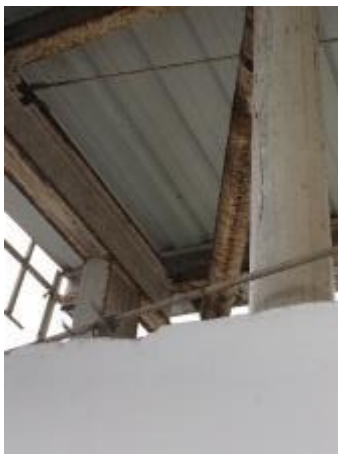
Figura 23 – Estrutura metálica da cobertura, oxidada
