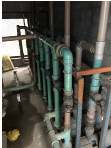
Figura 29: Casa de bombas: Bombas do sistema de abastecimento de água potável.
