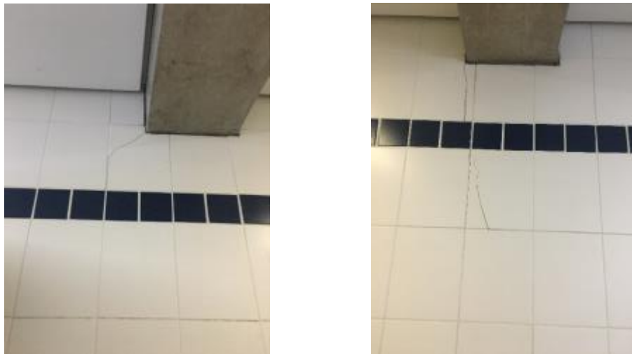
Figura 20: Trincas no revestimento cerâmico do sanitário
