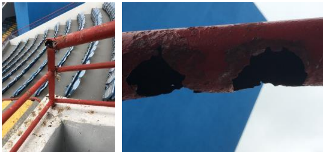
Figura 21 – Guarda corpo dos camarotes danificados e oxidados.
