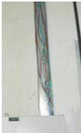
FIGURA 94 - ELETROCALHA DE ALIMENTAÇÃO - ABERTA
