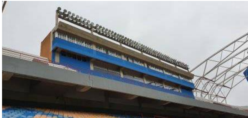
Figura 75: Setor C - Disposição das luminárias em bom estado, sem problemas aparentes de fixação.
