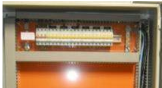
Figura 101: Alimentação lanchonetes - Setor B - Quadro em boas condições de uso e operação - Medição 2.
