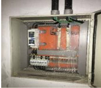
Figura 126: QF Elev. - VIP - Leste - Setor C - Quadro de força CC apresentando eletrocalhas abertas sem fechamento.
