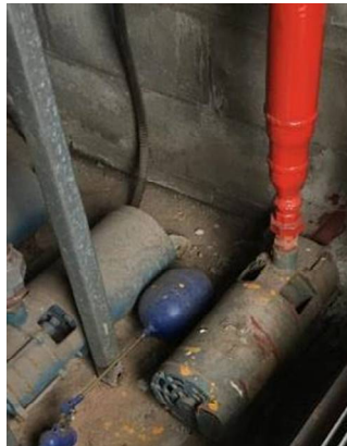
Figura 27: Casa de bombas: Bomba jockey.
