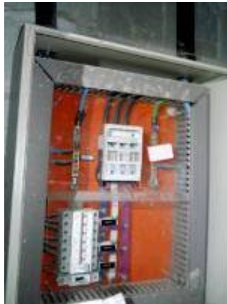
Figura 116: QDF - Torre 4 - QF Elev. 4 - 60 Hz - Quadro em boas condições de uso e operação.
