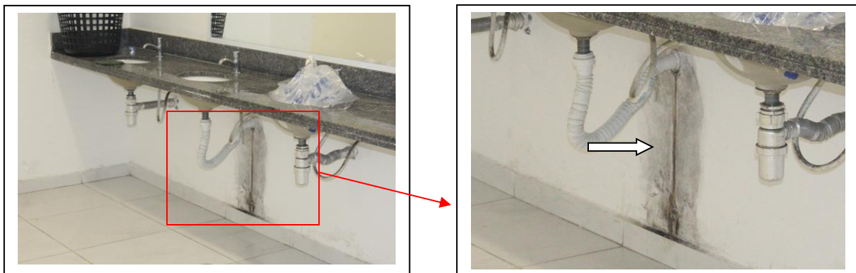
FOTOS 55A / 55B: MANCHA DE INFILTRAÇÃO
