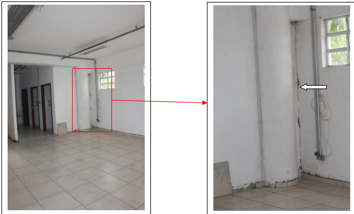
FOTOS 34A / 34B: TRINCA
