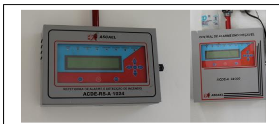
FOTOS 340 E 341: CENTRAL DE ALARME DE INCÊNDIO - GINÁSIO
