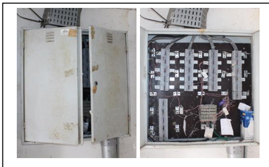
FOTOS 298 E 299: DG – TELEFONIA - CABINE DE IMPRENSA
