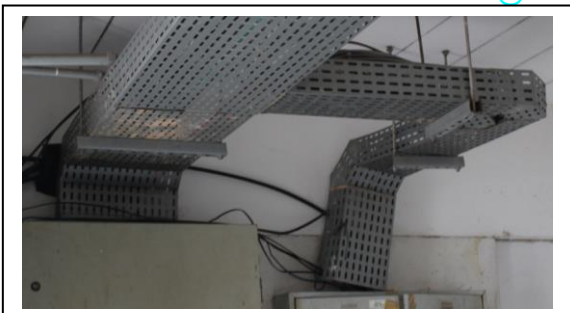
FOTO 137: QFL – ESTRUTURA DE ALIMENTAÇÃO FIXAÇÃO / QDL CAMAROTES
