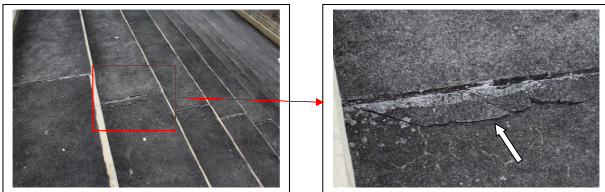
FOTOS 5A / 5B: REVESTIMENTO QUEBRADO – SETOR SUL
