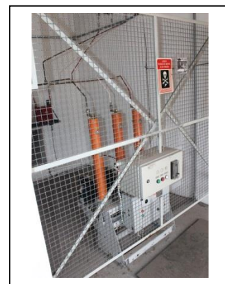
FOTO 114: DISJUNTOR A ÓLEO. CUBÍCULO DE PROTEÇÃO
