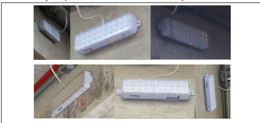
FOTOS 270 A 275: ILUM. EMERG. – ESCADAS DE EMERGÊNCIA
