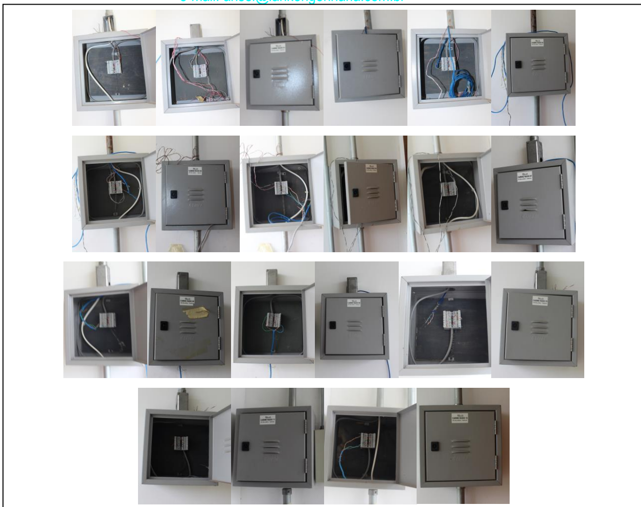
FOTOS 300 E 322: DG – TELEFONIA - CABINE DE RÁDIO DE 1 A 12
