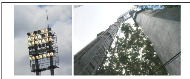
FOTOS 257 E 258: TORRE DE ILUMINAÇÃO 1
