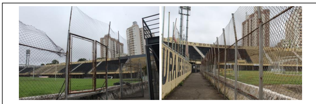
FOTO 295 E 296: ATERRAMENTO DAS GRADES METÁLICAS
