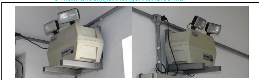
FOTO 265 E 266: ILUM. EMERG.- CABINE PRIMÁRIA
