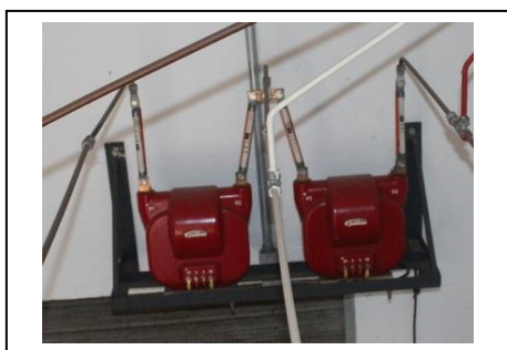
FOTO 112: TRANSFORMADOR DE INSTRUMENTOS ENTRADA DE ENERGIA
