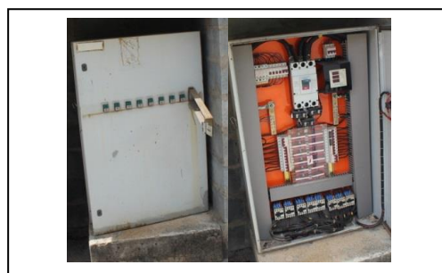
FOTOS 255 E 256: QFL – TORRE DE ILUMINAÇÃO 04
