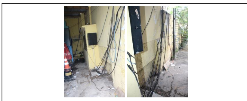
FOTOS 232 E 233: ALIMENTAÇÃO ENTRADA DE ENERGIA 2 PORTÃO PRINCIPAL.
