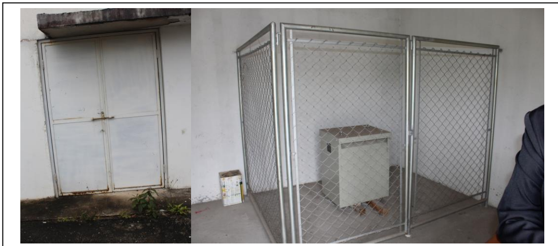
FOTOS 289 A 290: CUBICULO TRANSFORMADOR CABINE DE IMPRENSA
