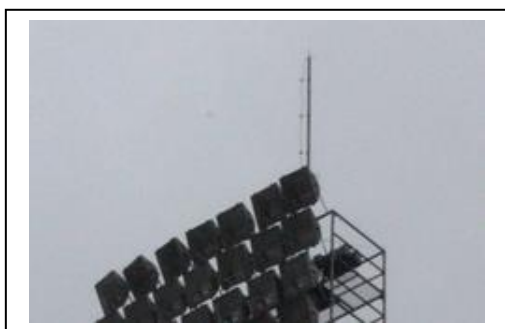
FOTO 291: ILUMINAÇÃO TORRE 1 APRESENTA SISTEMA DE SPDA
