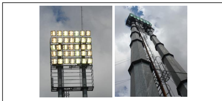
FOTOS 261 E 262: TORRE DE ILUMINAÇÃO 3
