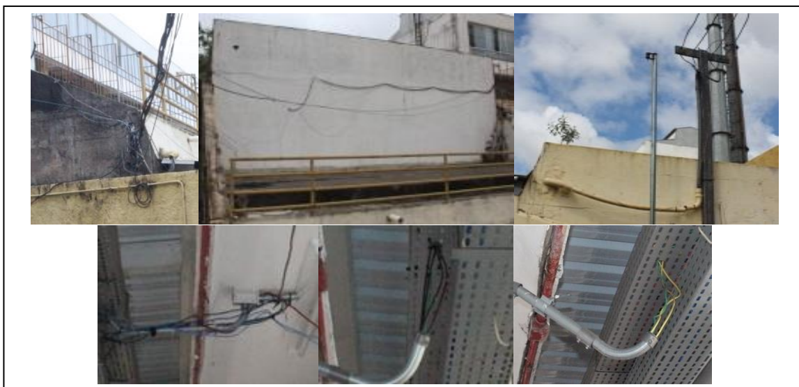
FOTO 240 A 245: ALIMENTAÇÃO VESTIÁRIOS
