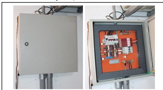
FOTOS 135 E 136: QFL – CABINE PRIMÁRIA.
