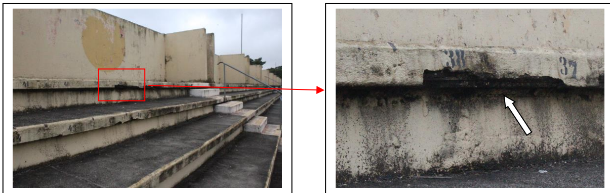
FOTOS 2A / 2B: DETALHES DA ARQUIBANCADA QUEBRADA COM ARMADURA EXPOSTA – SETOR LESTE
