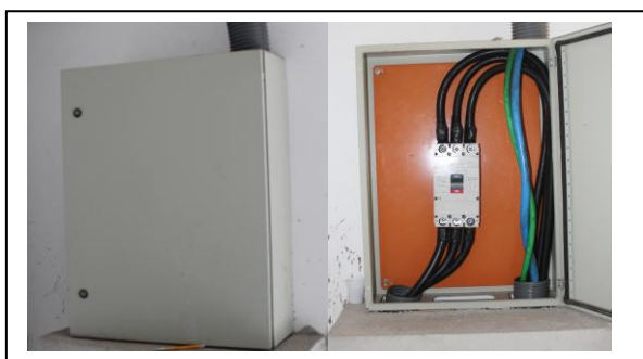
FOTOS 140 E 141: DISJUNTOR PRINCIPAL PROTEÇÃO DOS CAMAROTES
