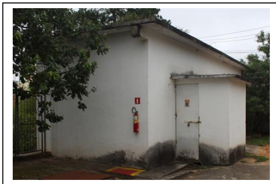
FOTO 109: CABINE PRIMÁRIA PORTÃO 1 ENTRE OS SETORES SUL E OESTE
