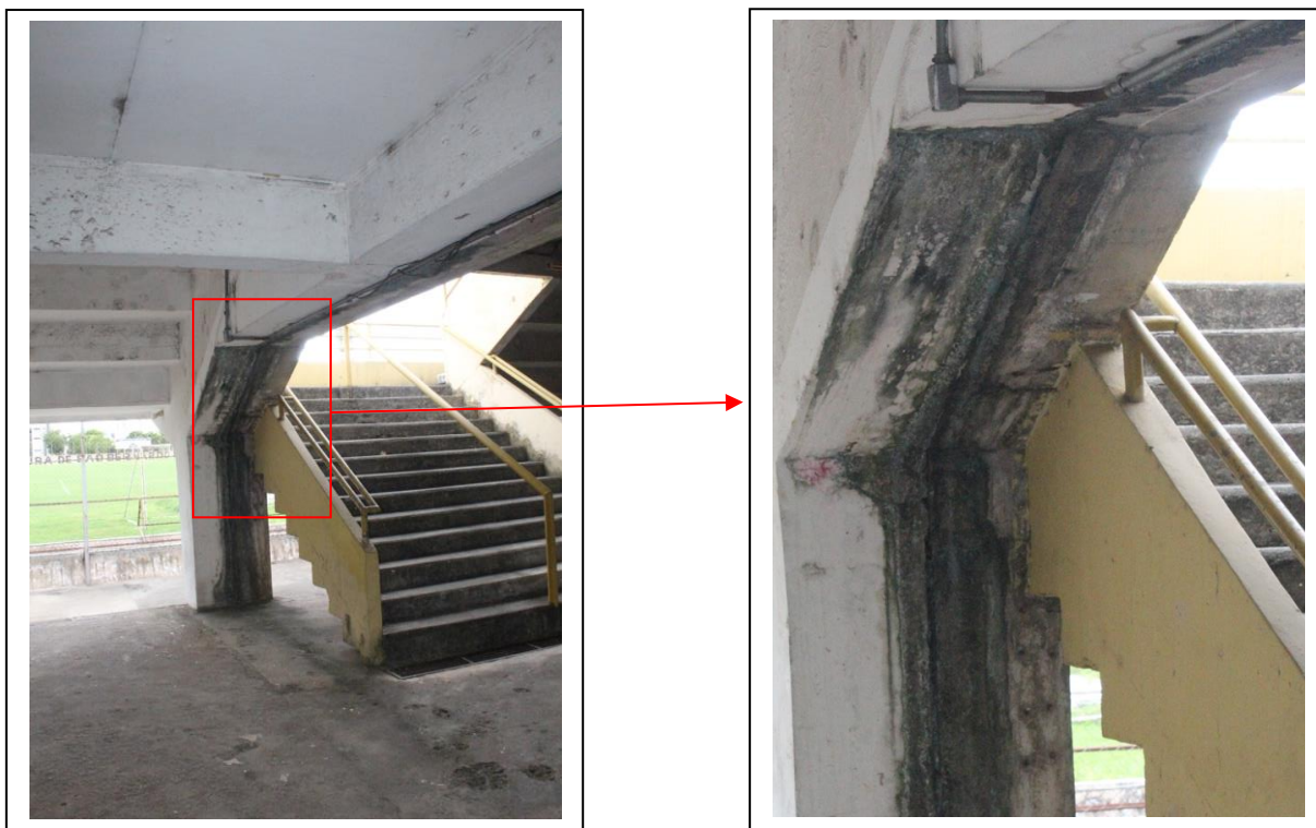
FOTOS 11A / 11B: MANCHAS DE UMIDADE NA JUNTA DE DILATAÇÃO
