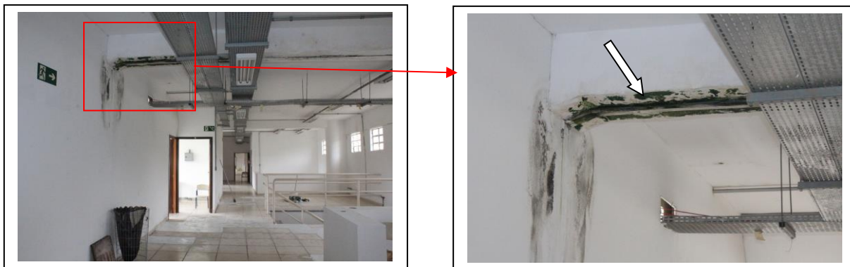
FOTOS 41A / 41B: MANCHAS DE UMIDADE NA JUNTA DE DILATAÇÃO
