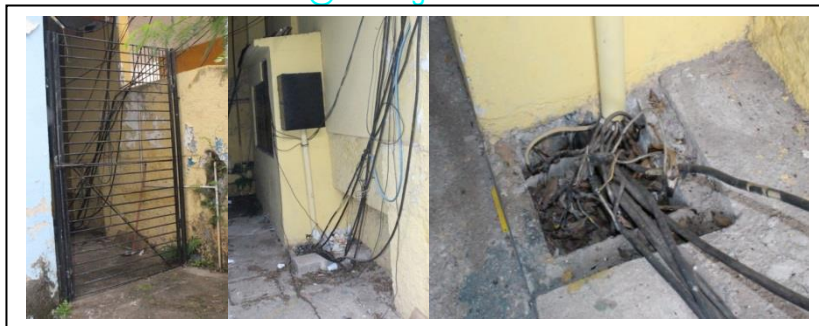
FOTOS 130 A 132: QFL 1 – QUADRO GERAL DE PROTEÇÃO ENTRADA SECUNDÁRIA
