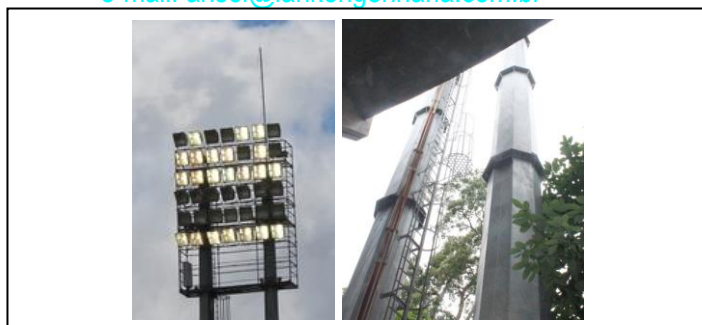
FOTOS 259 E 260: TORRE DE ILUMINAÇÃO 2
