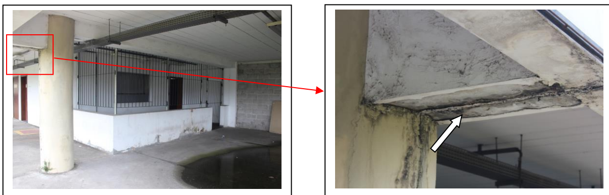
FOTOS 27A / 27B: LANCHONETE E INFILTRAÇÃO
