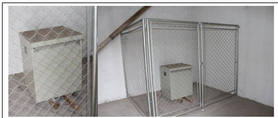
FOTOS 138 E 139: TRANSFORMADOR DE ALIMENTAÇÃO DOS CAMAROTES
