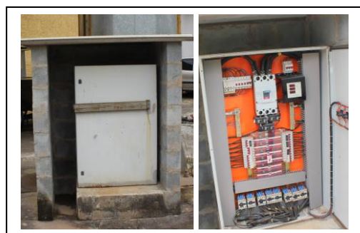
FOTOS 251 E 252: QFL – TORRE DE ILUMINAÇÃO 02
