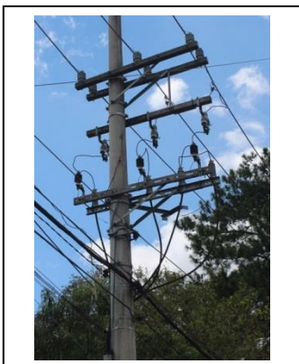
FOTO 101: ENTRADA DE ENERGIA
