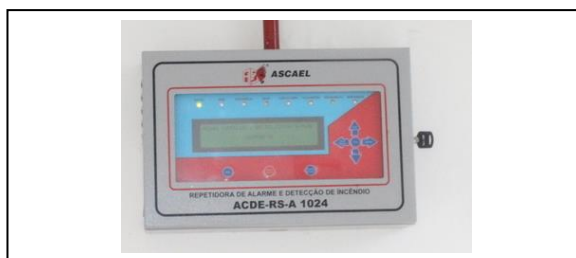
FOTO 342: CENTRAL DE ALARME DE INCÊNDIO - CAMAROTE
