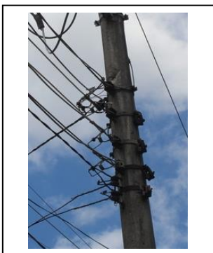
FOTOS 125: ENAMINHAMENTO DE CABOS JUNTO AO POSTE DA CONCESSIONARIA.
