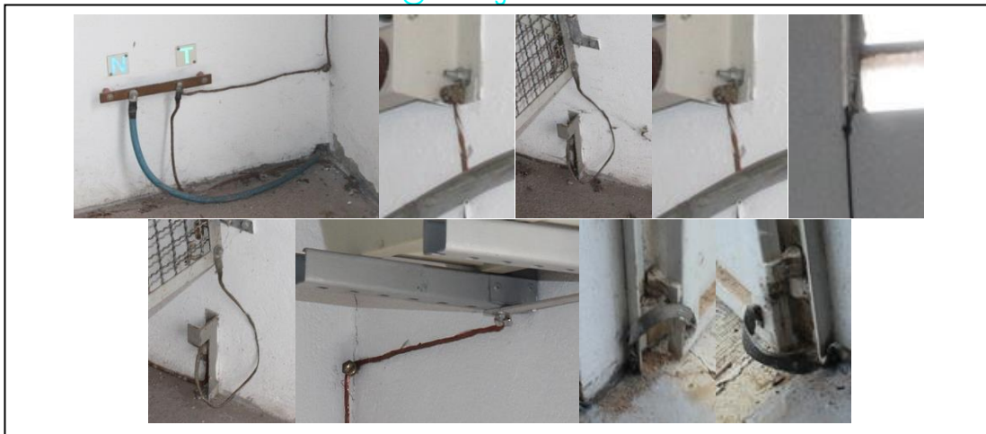
FOTOS 280 A 288: ATERRAMENTO CABINE PRIMÁRIA
