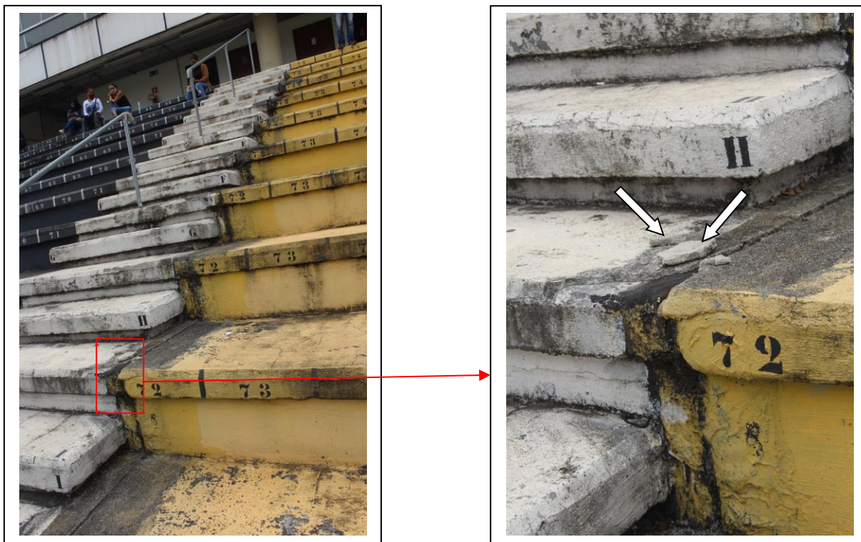
FOTOS 22A / 22B: REVESTIMENTO PRÓXIMO A JUNTA QUEBRADO COM PARTES SOLTAS
