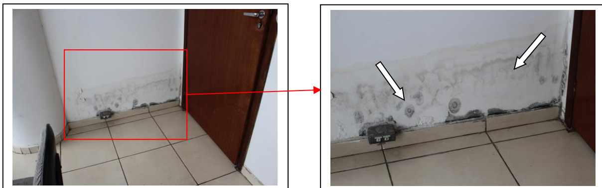
FOTOS 33A / 33B: MANCHAS DE UMIDADE
