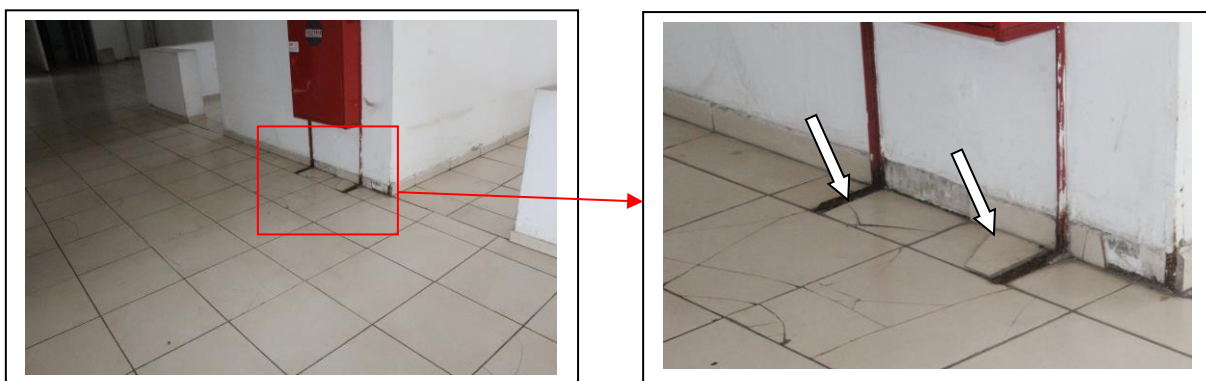
FOTOS 36A / 36B: PISO TRINCADO E QUEBRADO
