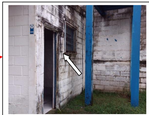
FOTOS 47A / 47B: MANCHAS NO REVESTIMENTO EXTERNO DA EDIFICAÇÃO
