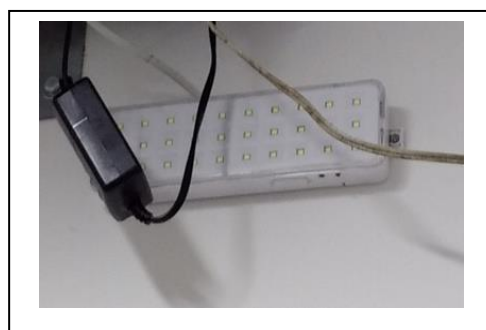
FOTO 230: ILUMINAÇÃO DE EMERGÊNCIA VESTIÁRIO DOS ARBITROS
