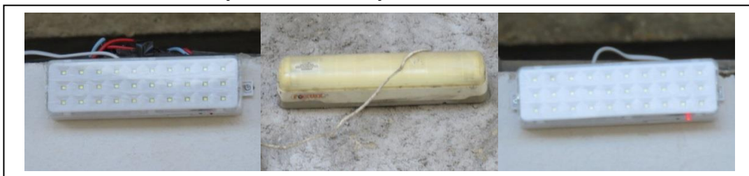
FOTO 224: ILUM. EMERG. BAR – ARQUIBANCADA COBERTA
