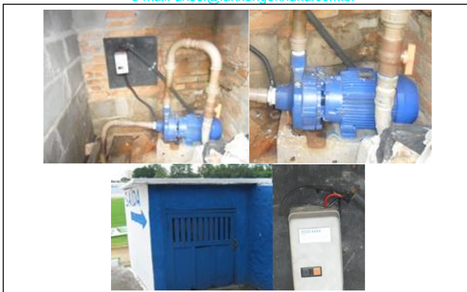
FOTOS 119 E 122: QUADRO DE COMANDO – BOMBA RESERVATÓRIO – SETOR 8
