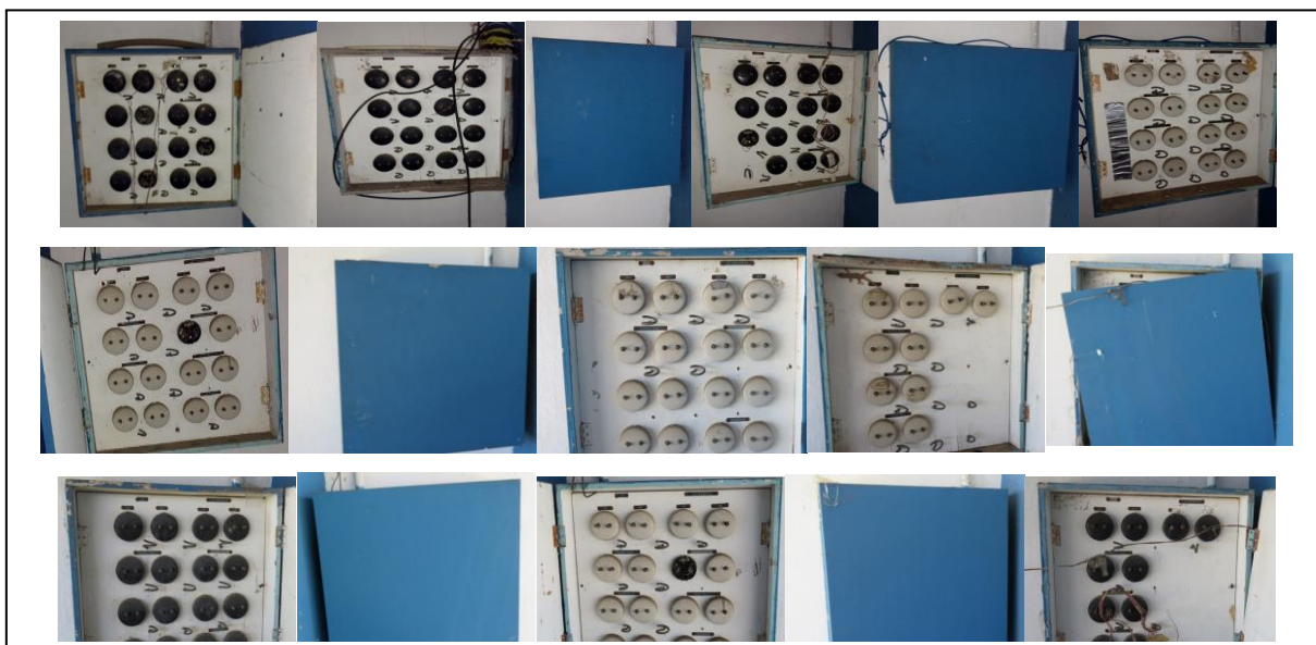
FOTOS 238 A 253: QUADROS DE TELEFONIA CABINE DE IMPRENSA
