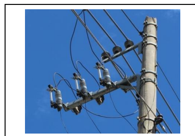
FOTOS 102: CRUZETAS EM BOAS CONDIÇÕES DE INSTALAÇÃO
