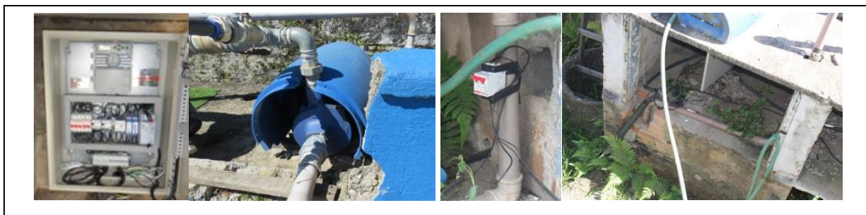
FOTOS 136 A 139 – INSTALAÇÕES ELÉTRICAS BOMBA DE IRRIGAÇÃO
