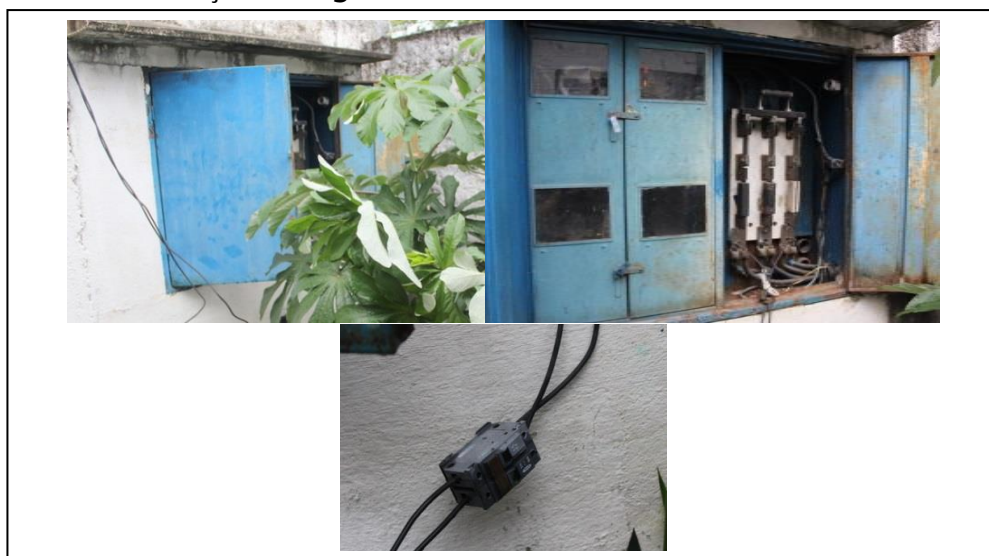
FOTOS 109 A 111: QUADRO DE MEDIÇÃO/PROTEÇÃO ENTRADA PRINCIPAL.
