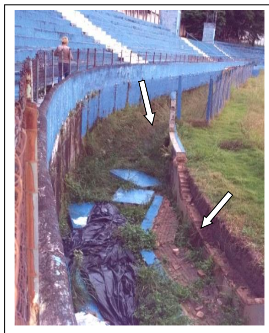
FOTOS 55A / 55B / 55C: EXTENSÃO SEM MURO OU COM DESABAMENTO SOBRE O FOSSO
