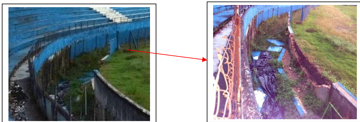
FOTOS 41A / 41B: MURETA QUEBRADA
