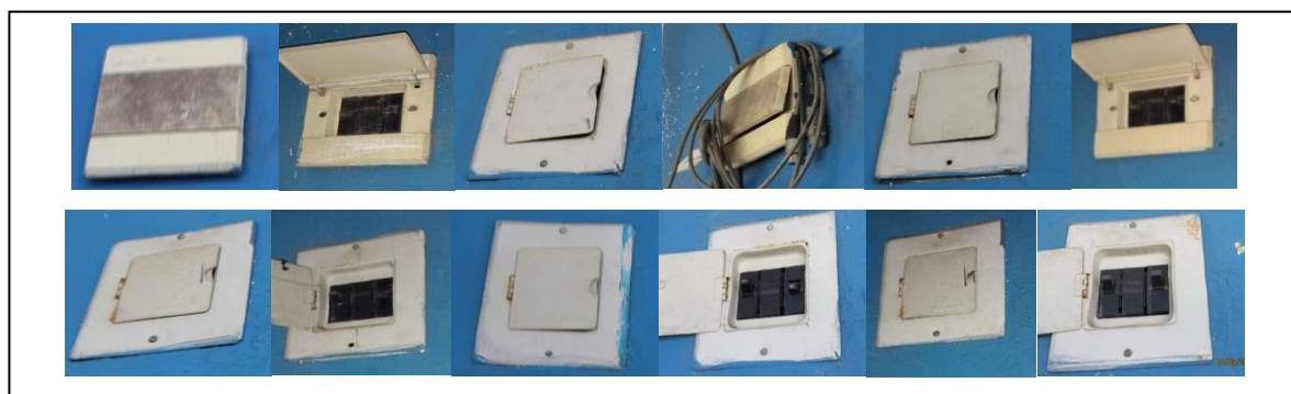
FOTOS 143 A 155: QUADROS DE PROTEÇÃO – CABINES
