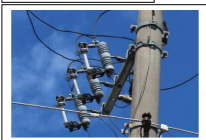
FOTO 104: CHAVE FUSÍVEL EM BOAS CONDIÇÕES DE INSTALAÇÃO
