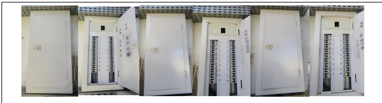
FOTOS 201 E 206 – QFL –TORRES DE ILUMINAÇÃO 1 A 3 ARQUIBANCADA COBERTA
