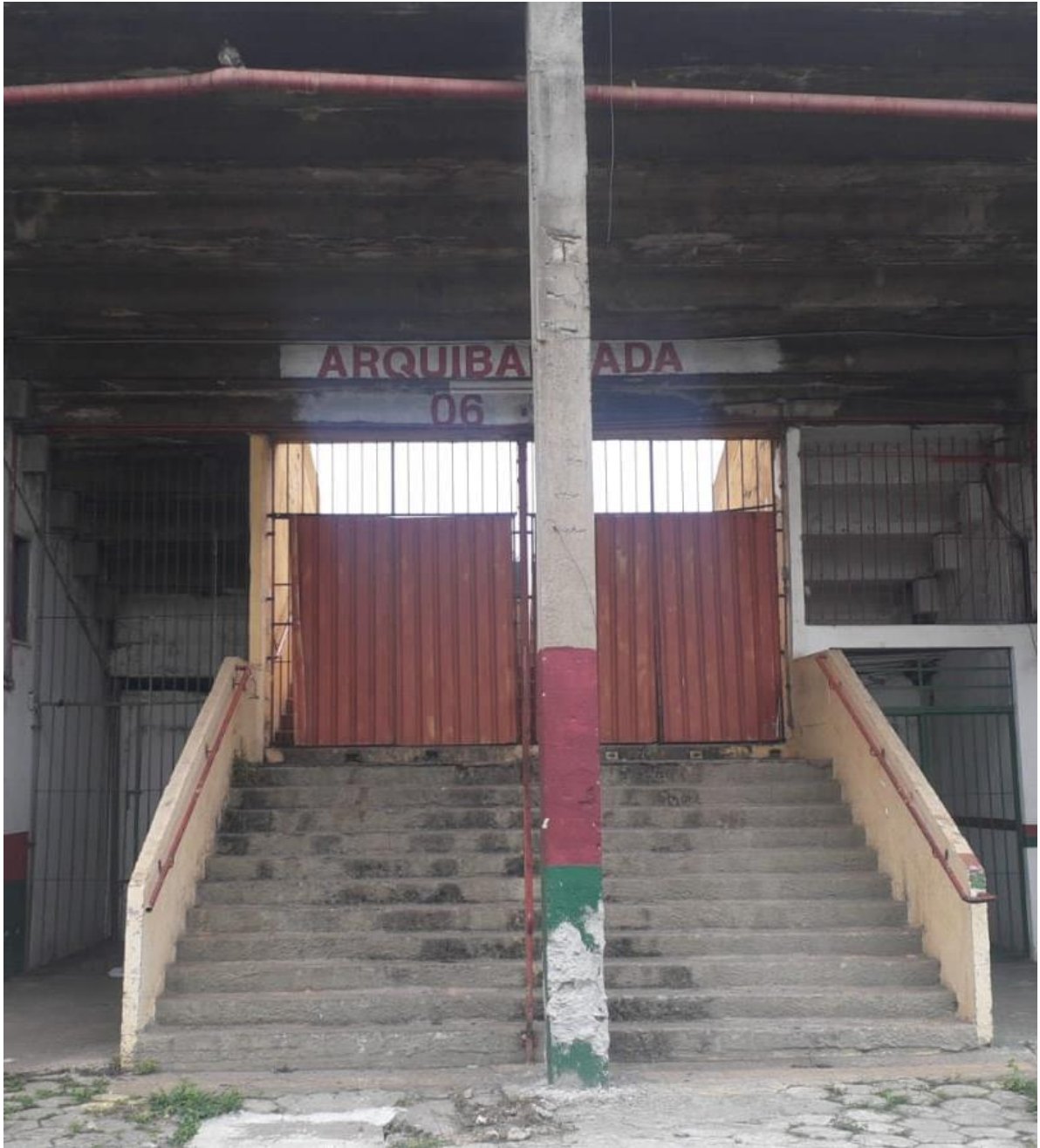
Figura 38: Problemas Estruturais no Acesso 06 das arquibancadas
