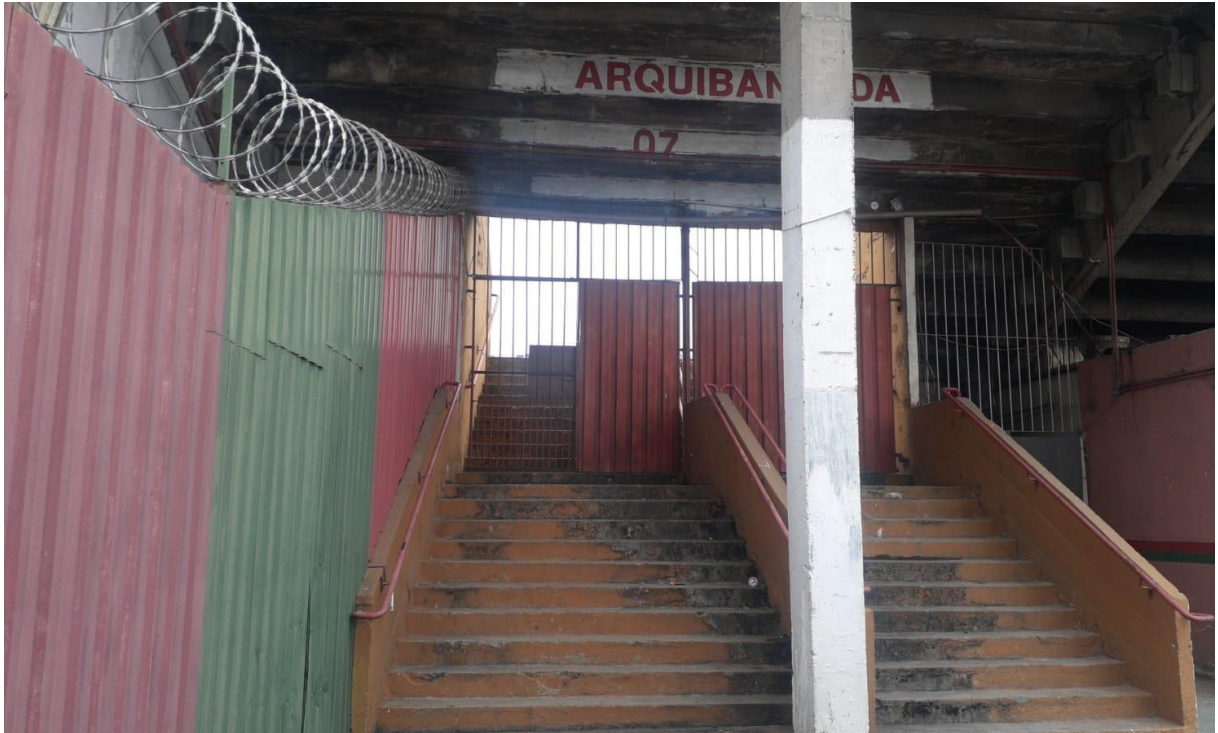
Figura 39: Problemas Estruturais no Acesso 07 das arquibancadas
