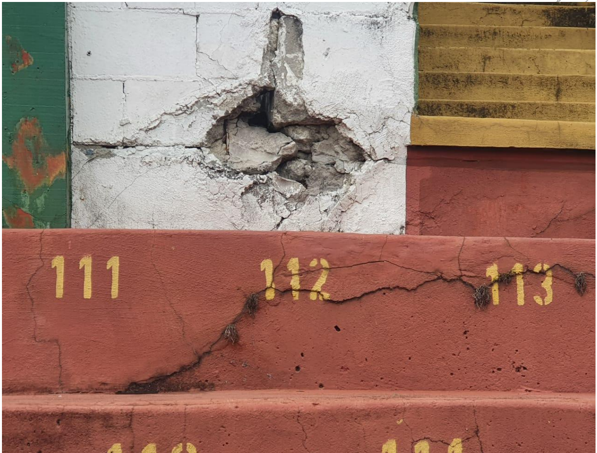
Figura 36: Problemas Estruturais do Estádio
