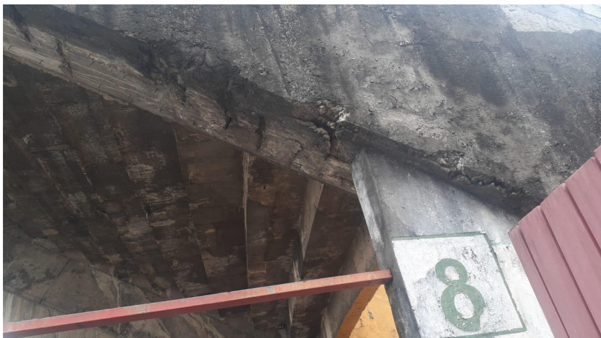
Figura 34: Problemas Estruturais no Acesso 08 das arquibancadas
