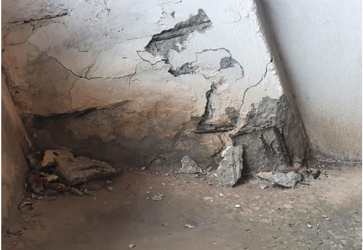
Figura 35: Problemas Estruturais do Estádio
