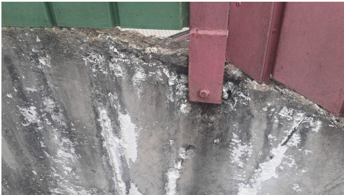
Figura 33: Problemas Estruturais do Estádio
