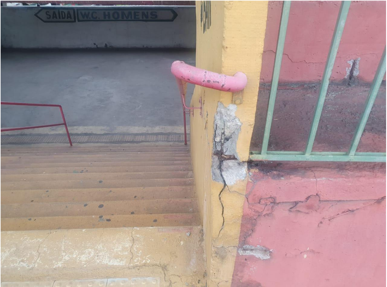
Figura 37: Problemas Estruturais do Estádio
