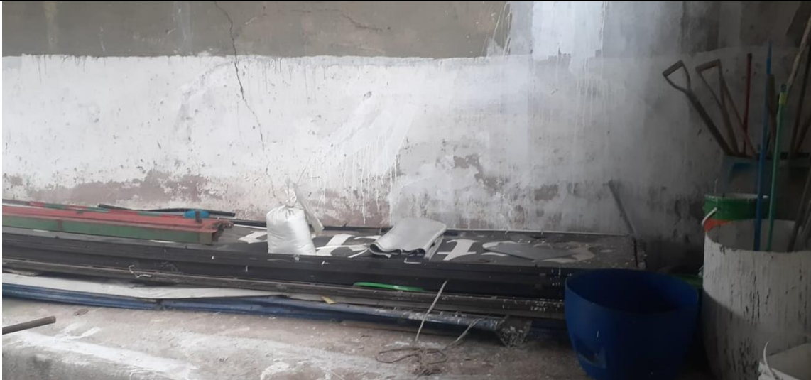
Figura 28: Resto de obras e materiais perigosos
