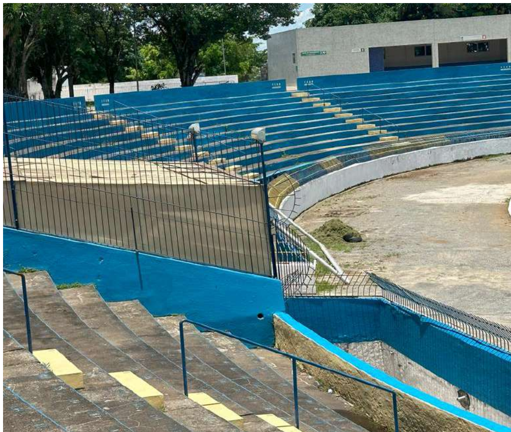
Imagem 19: Grades e fosso de proteção
