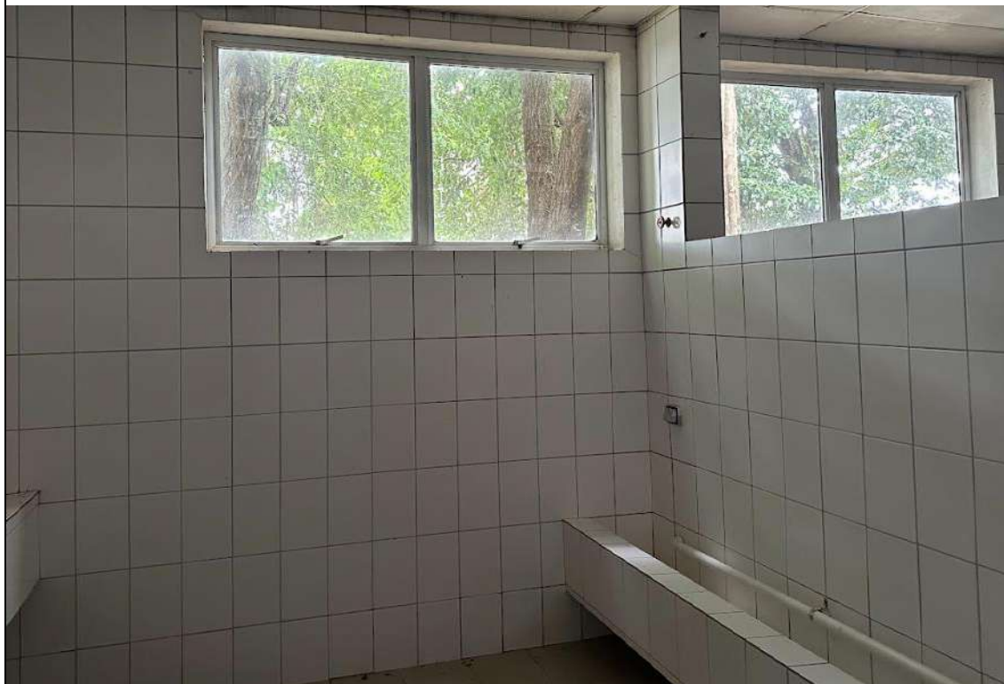
Imagem 24: Janela onde é possível passar objetos não autorizados
