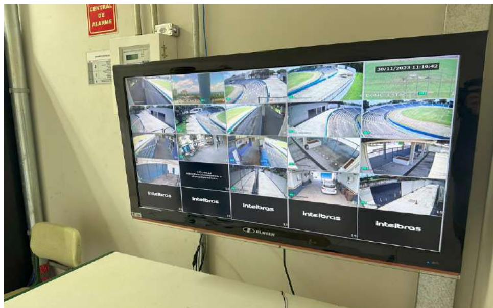
Imagem 9: Sala destinada ao CFTV
